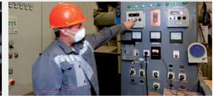
Проверка управляющего оборудования
